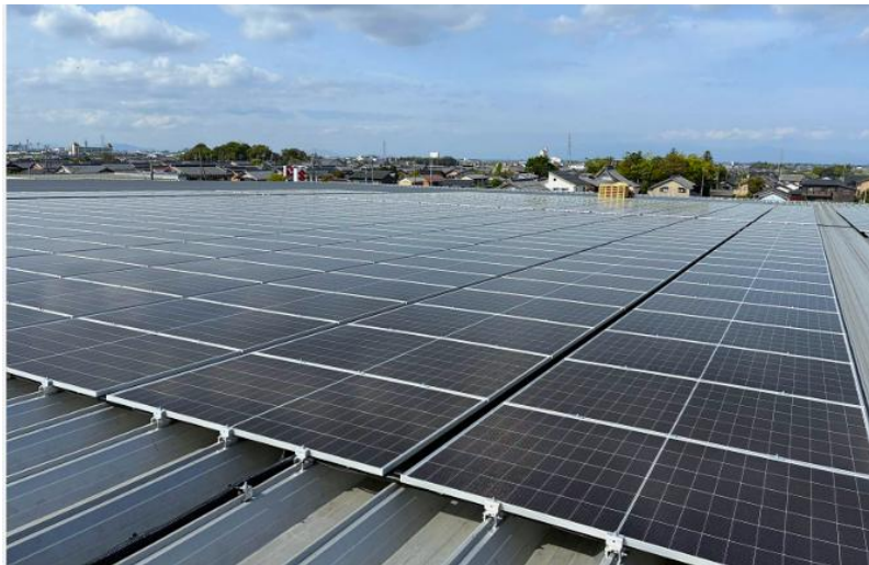
※ 長浜 CK に増設した太陽光発電設備
