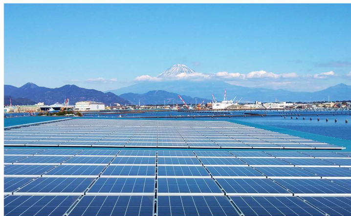
(写真：三保工場 屋上型太陽光パネル)
